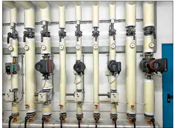
Elektronische Heizungspumpen Sporthalle Neubulach
