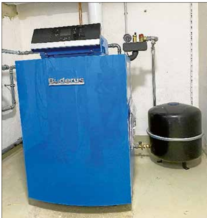
Gasheizung mit Ausdehnungsgefäß
